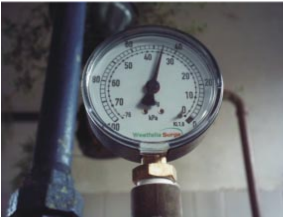
Figura 4. Medidor de vácuo localizado na sala de ordenha.
