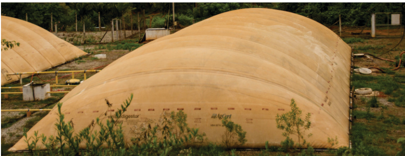
Figura 11 - Biodigestor alimentado por esterco de galinha. O gás produzido alimenta geradores tornando-os autossuficientes em energia elétrica.
