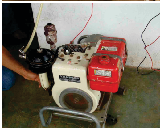
Figura 5 - Geração de energia elétrica a partir do biogás também tem sido muito utilizada, alimentando geradores de energia. Veja que mesmo em grandes motores de geração de energia são utilizados canos de PVC para a alimentação com o gás metano.
