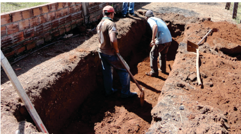
Figura 14 – Escavação para biodigestor de 1,4 m de diâmetro e 3 m de comprimento. De forma geral, a escavação é realizada com máquina, mas o acabamento fino deve ser feito de forma manual.
