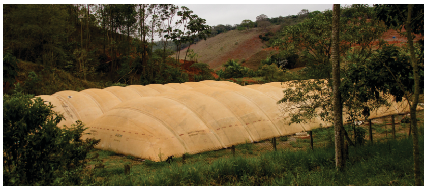
Figura 12 – Conjunto de biodigestores com capacidade de tratamento do esterco de mais de 1500 matrizes, produzindo 3.000 metros cúbicos de gás por dia.
