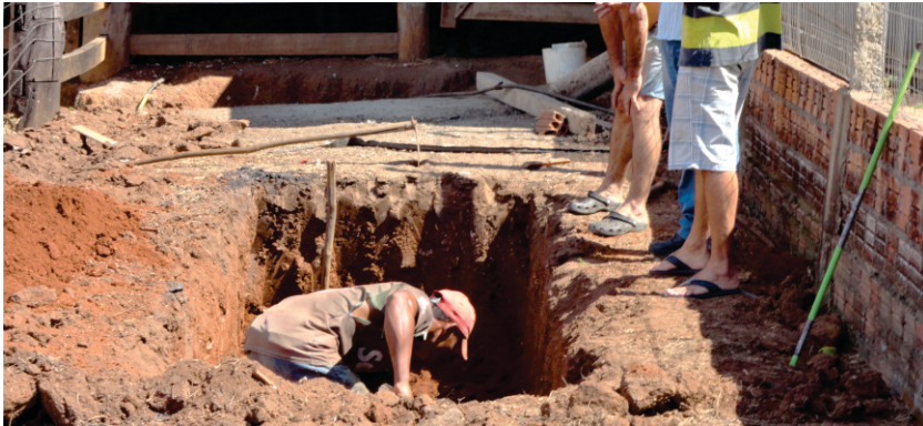
Figura 13 – Biodigestor sendo construído próximo ao curral, o que facilita o transporte do esterco para realizar a sua carga frequente.
