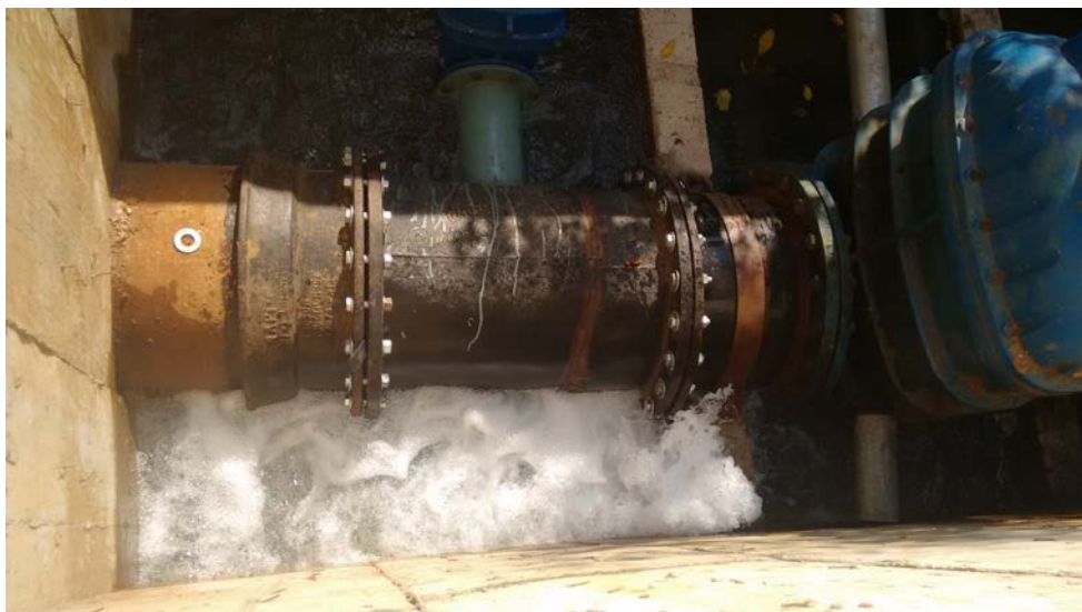
Foto 01- Adutora na saída da ETA
