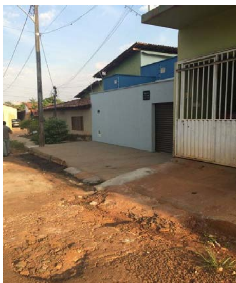
Situação da pavimentação local
