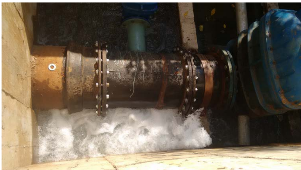
Foto 01- Adutora na saída da ETA
