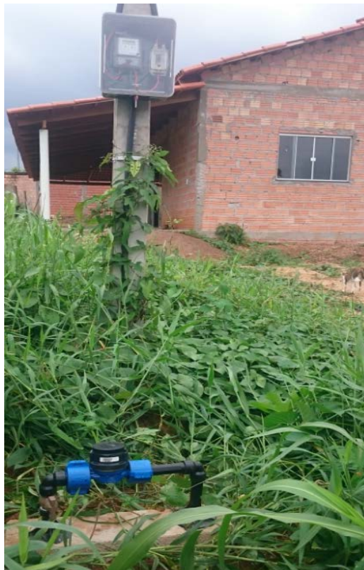
Foto 01: Hidrômetro instalado na casa da cliente Luzia Aguiar da Silva
