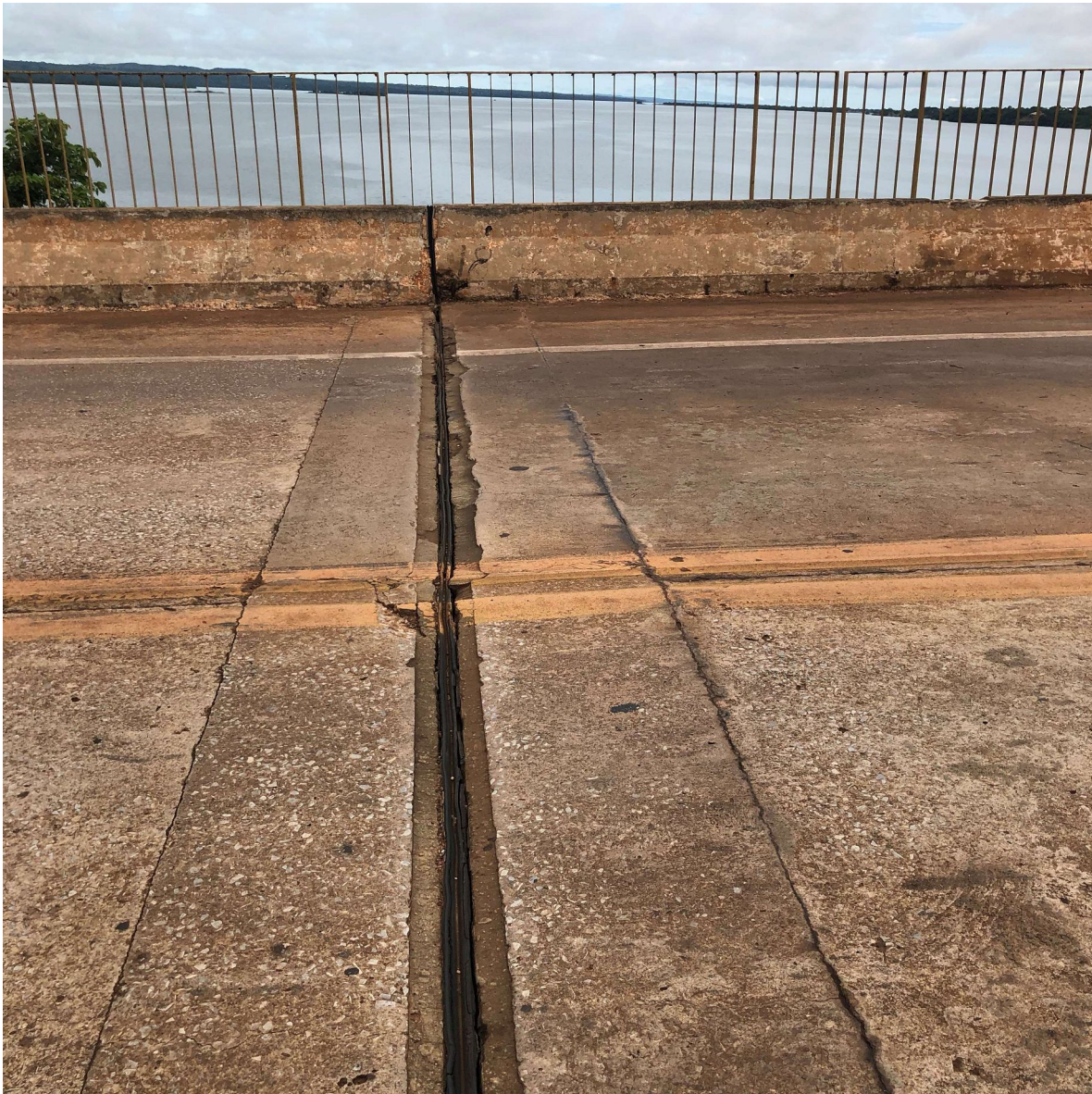
Figura 17 – junta de dilatação danificada.
