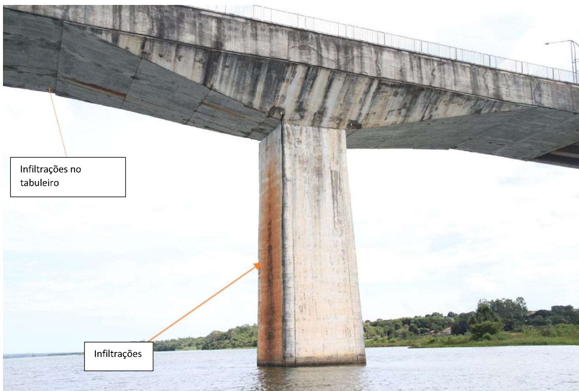
Foto 1 – Pilar da ponte indicando infiltrações do tabuleiro.
