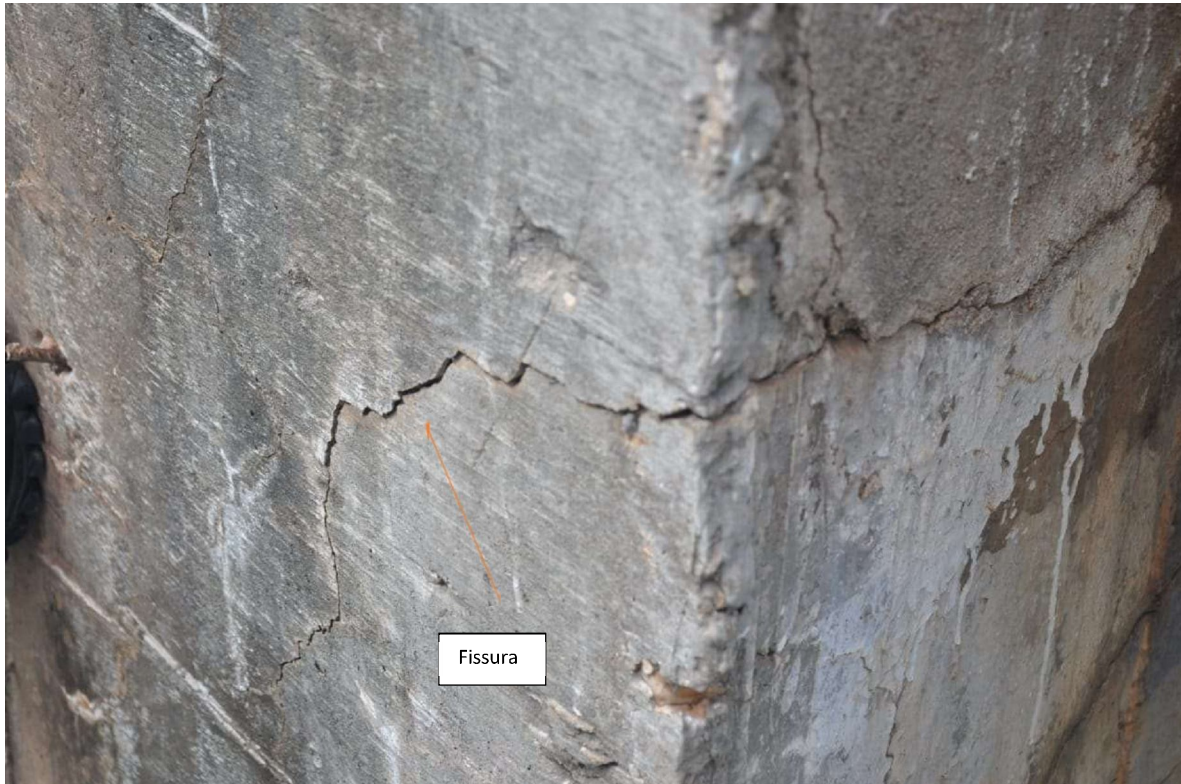
Foto 4 – Detalhe da fissura do dente devida RAA.
