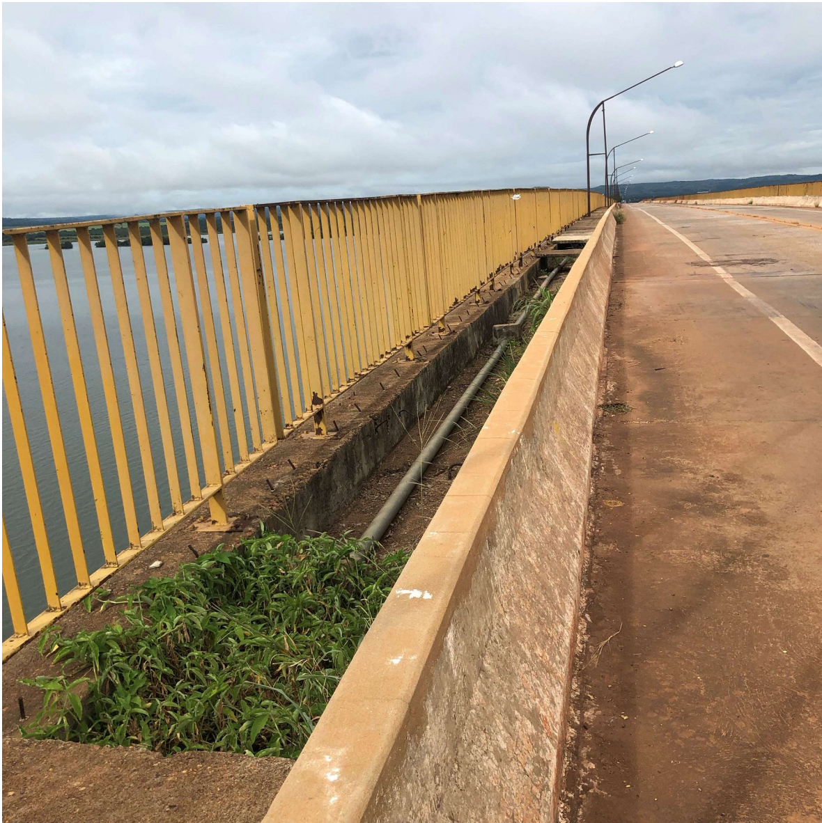
Foto 10 – Detalhe da danificação do passeio, lado montante.
