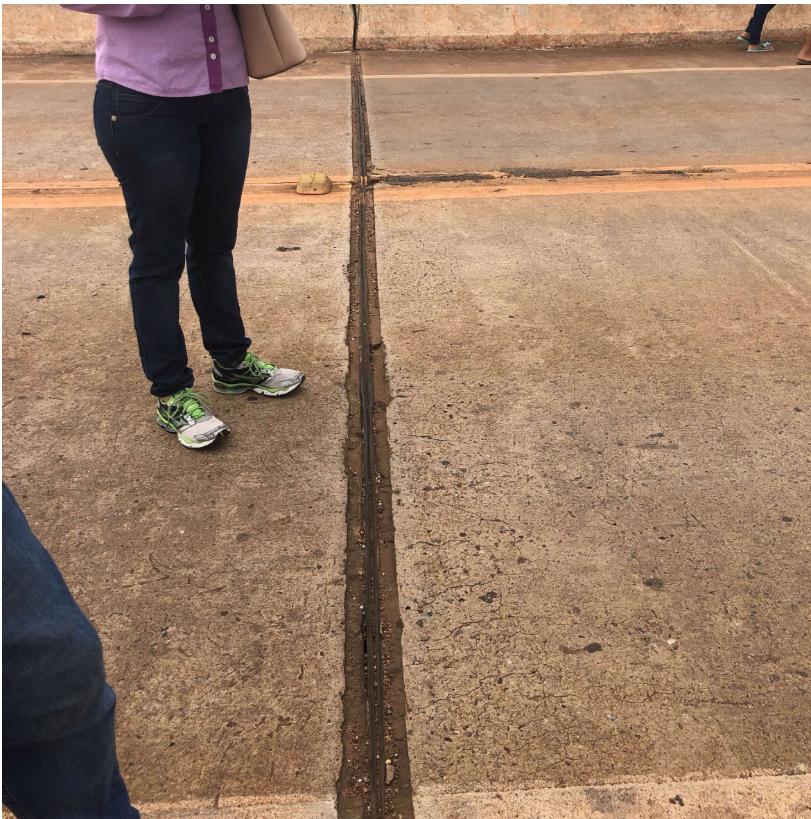
Foto 7 – Junta de dilatação danificada.
