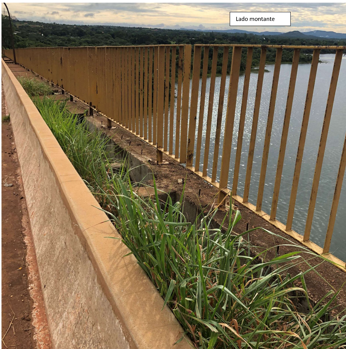
Foto 8 – Passeio de pedestres em condições precárias de uso, lado montante.
