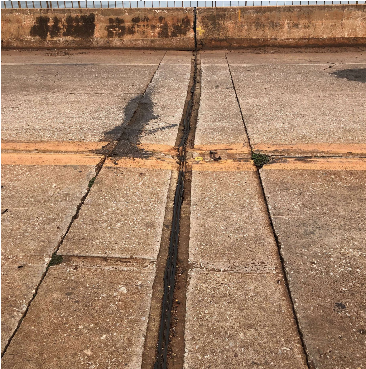
Figura 13 – detalhe da junta de dilatação danificada.
