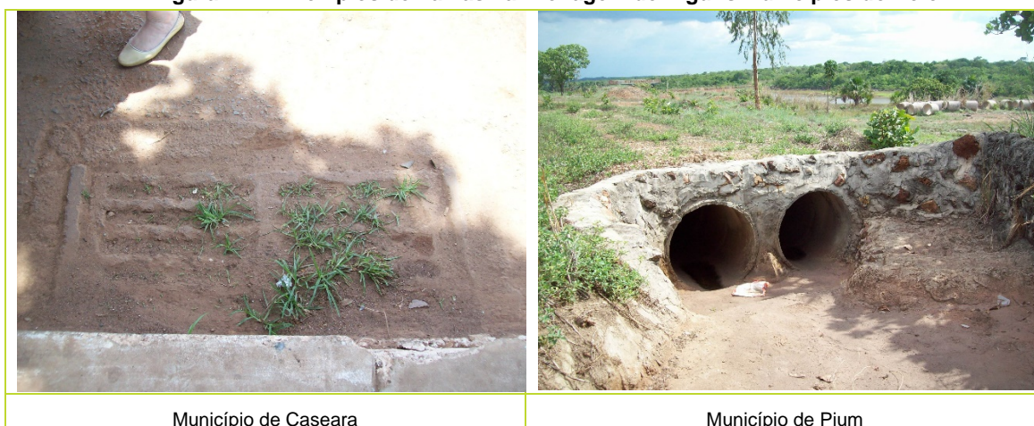
Figura 47: Exemplos de Falhas na Drenagem de Alguns Municípios do Polo
