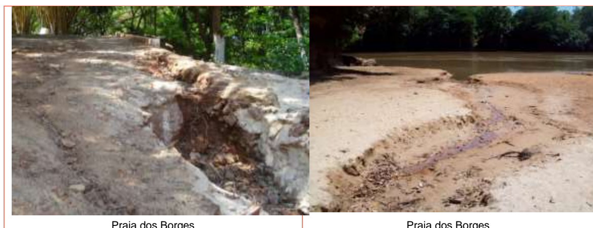
Figura 67: Falta de Drenagem Pluvial em Atrativos do Município de Novo Acordo
