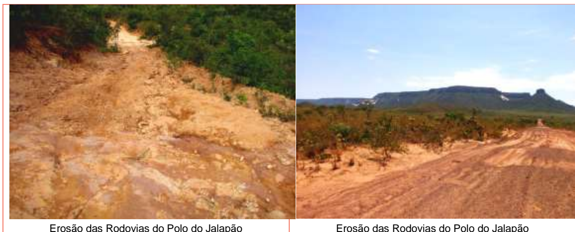
Figura 68: Erosão Rodovias do Polo do Jalapão
