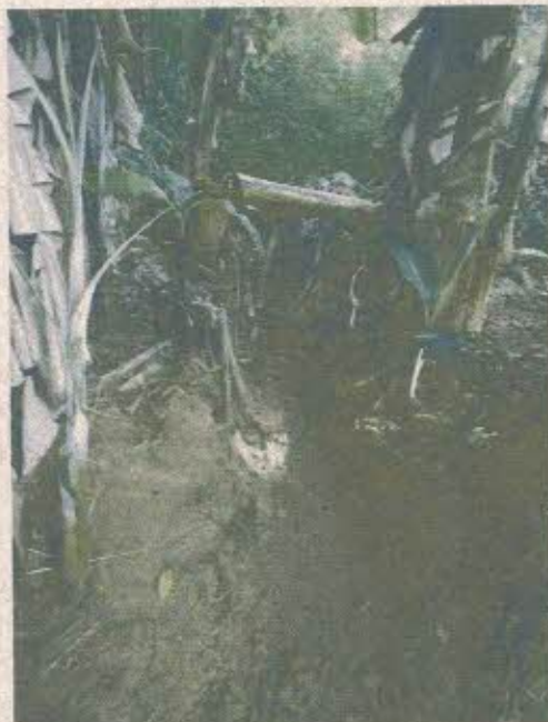
Figura 5: PROCESSO EROSIVO NO BANANAL
