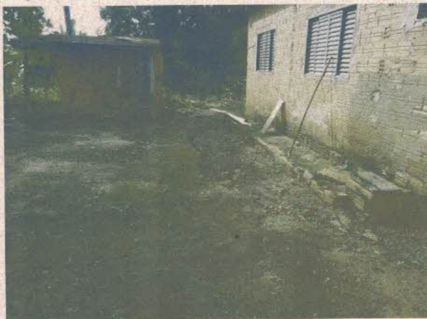
Figura 4: A AGUA COLIDE COM A RESIDENCIA E DERRUBANDO CONSTRUÇÃO AO FUNDO
