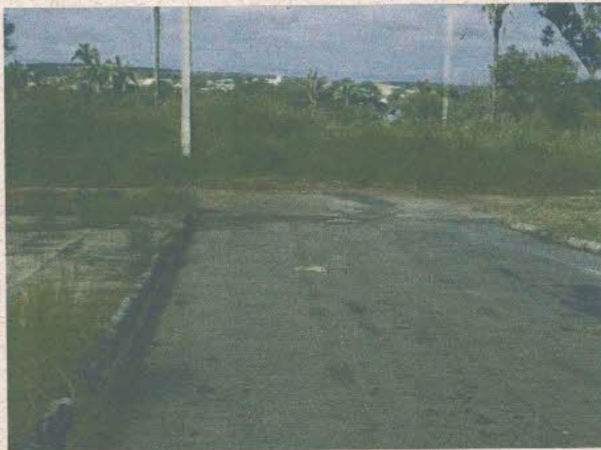
Figura 1: LOCAL POR ONDE A ÁGUA PENETRA NA CHACARA DO SR. EDSON BARROS
